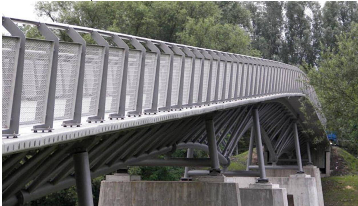
پل Gärtnerplatzbrücke، اولین پلی که با استفاده از بتن UHCP در سال ۲۰۰۷ در آلمان افتتاح شد. ۶۷
